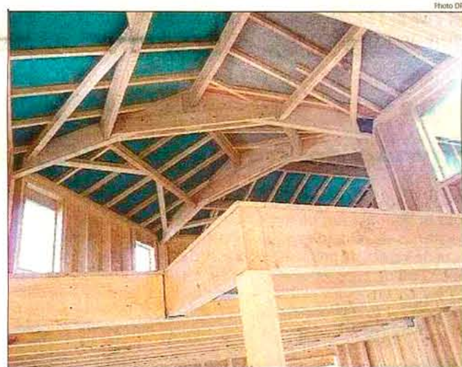
L'ossature bois dans toute sa splendeur. Ici, une vue d'une mezzanine et du « squelette » de la maison
